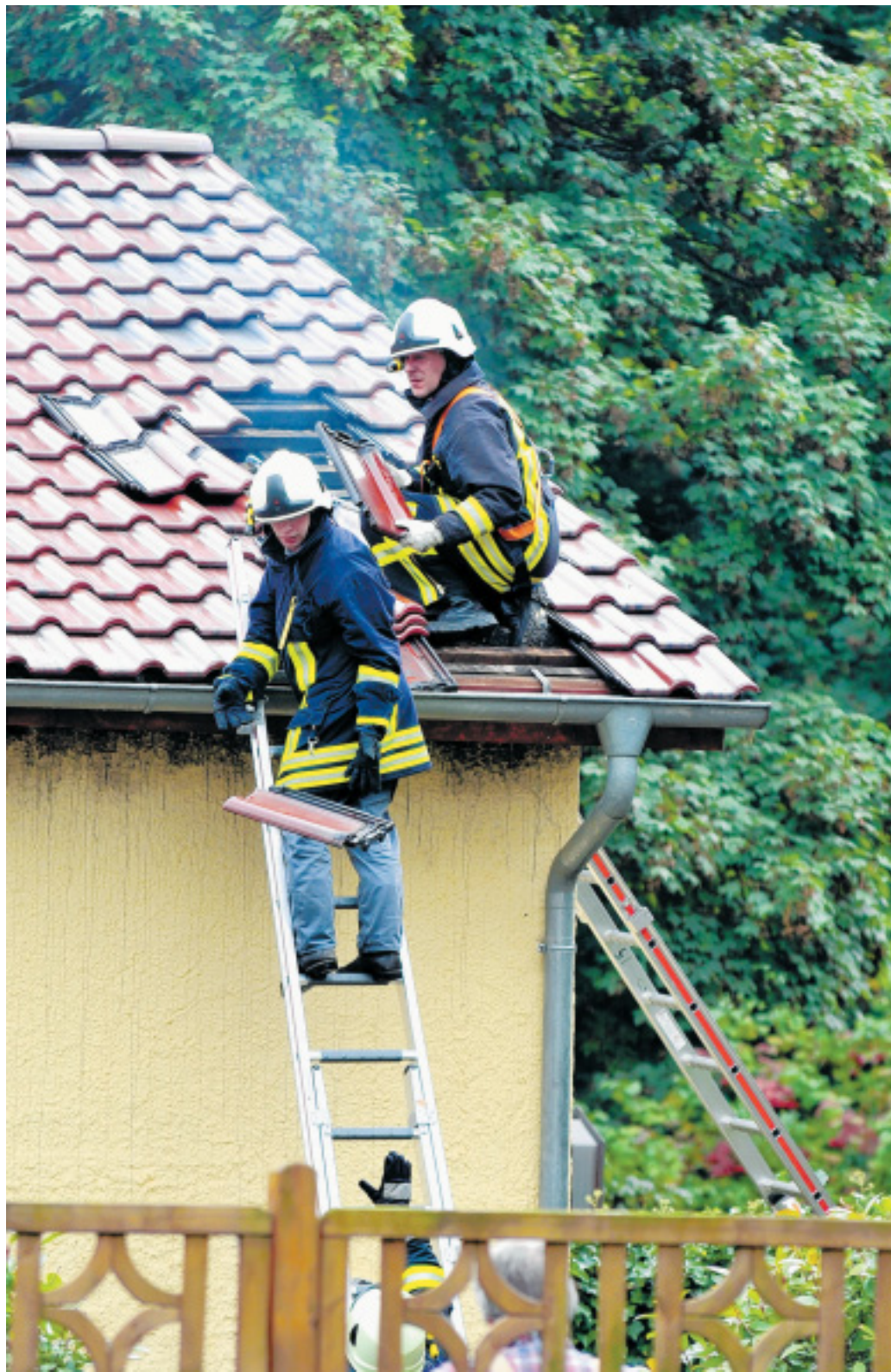
Über das Dach: Einsatzkräfte räumen Ziegel beiseite, während es aus der betroffenen Wohnung immer noch qualmt. An der Fassade unterhalb der Regenrinne sind Rauchspuren zu erkennen. FOTOS: KARL-H. TITTEL
